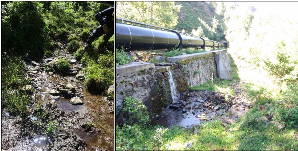
Figure 29 : Zone de ruissellement après piétinement et écoulement sous la CF
