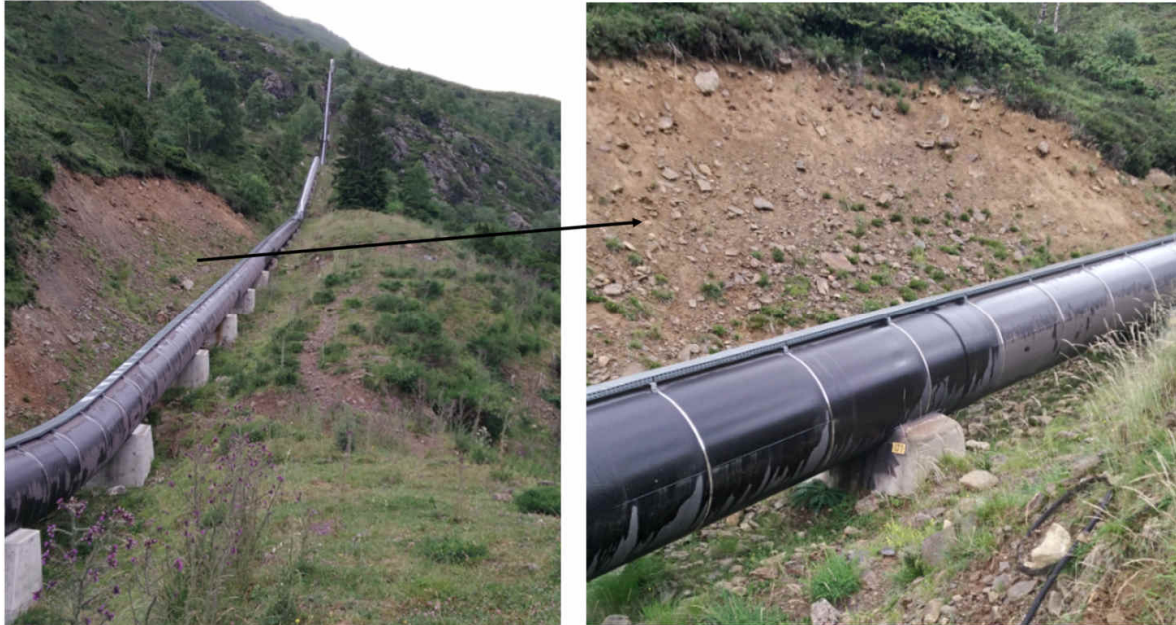
Figure 10 : Vue du talus érodé en rive droite de la CF de Gnioure
