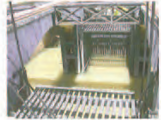
Étang de la DDCP / Écrêtement de la planche
