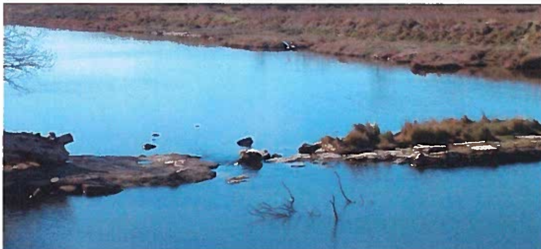
Figure 23 : Seuil aval présentant d'importantes dégradations
