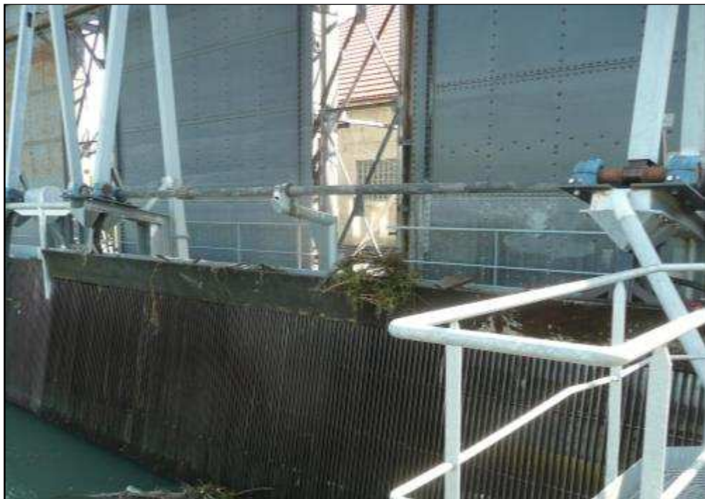
Figure 17 : Exemple dégrilleur Olano sur le site de Pointis (31)
