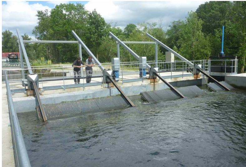
Figure 5: Dégrilleur à crémaillère
