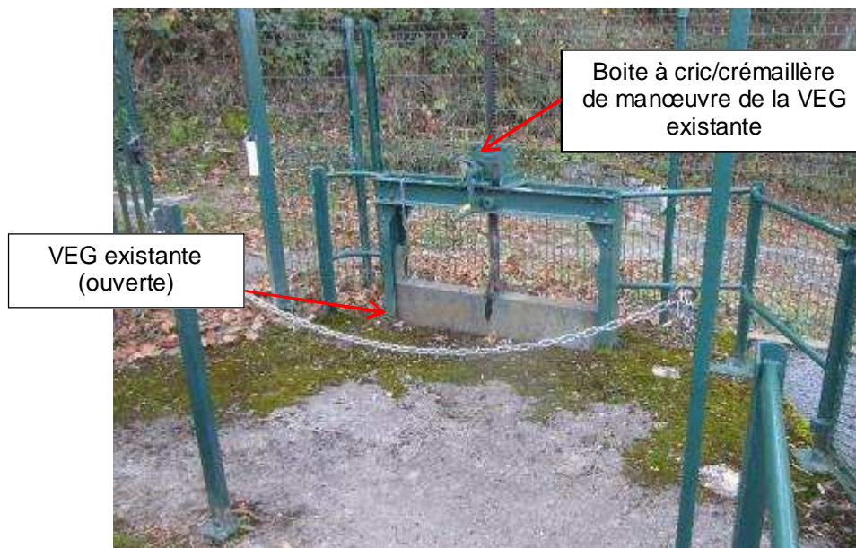
Figure 11 : Accès au système de manœuvre vanne entrée galerie existante
