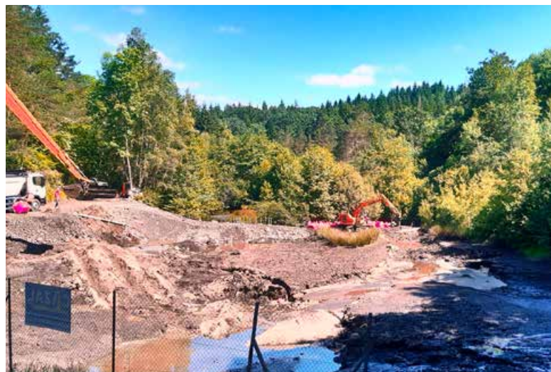
Prise d'eau des Agrès vidangée photo EDF
