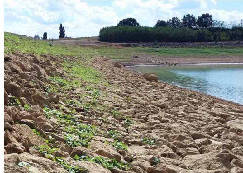
Barrage de Saclès, zone de décrochement du parement amont photo CACG
