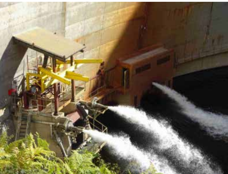
Dispositif de vidange de fond du barrage de Roujanel (Lozère) - photo DREAL Occitanie
