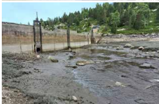
Retenue de Pla-des-Escales en haut: avant travaux — en bas: après travaux photo EDF
