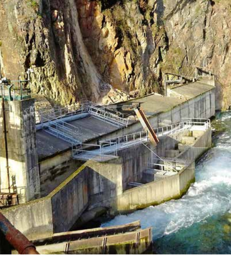
Falaise éboulée au niveau de la prise d'eau de Pont-de-la-Reine (Hautes-Pyrénées) - photo DREAL Occitanie
