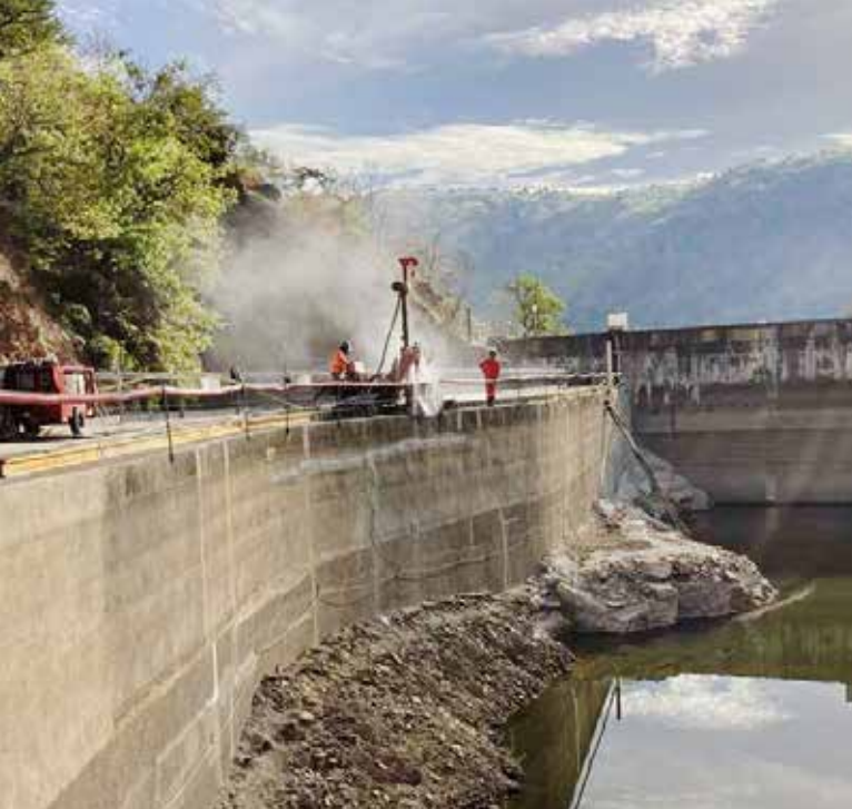
Travaux en cours sur le seuil du barrage de Thuriès, à Pampelonne (Tarn) - photo DREAL Occitanie
