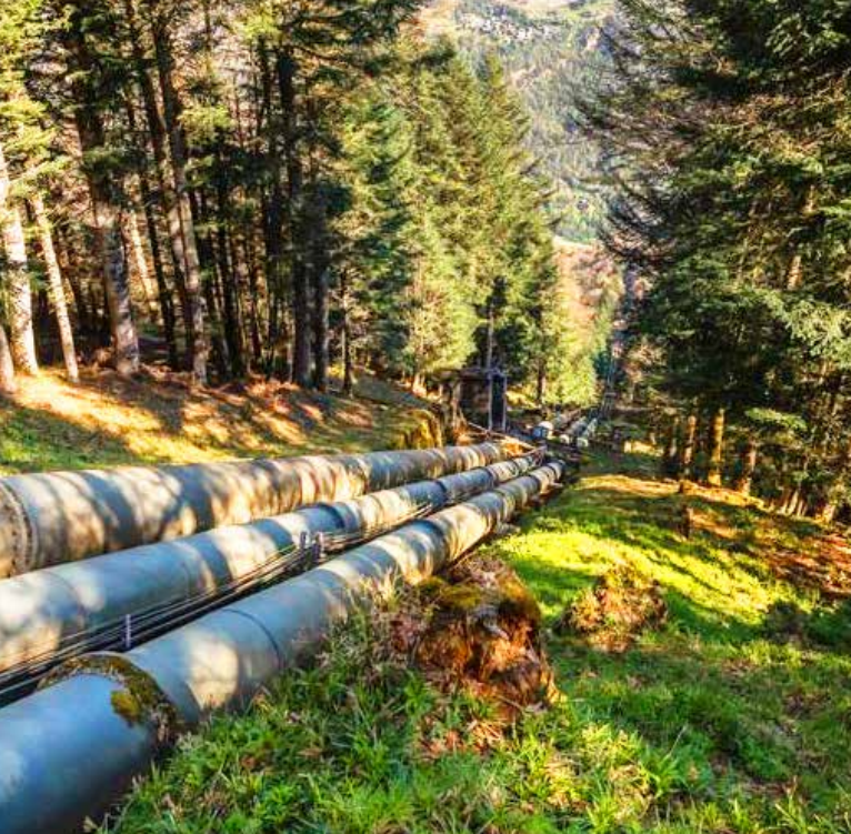
Conduite forcée du lac d'Oô
