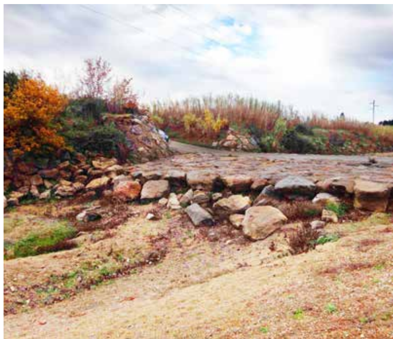
Passage à gué à consolider - photo DREAL Occitanie
