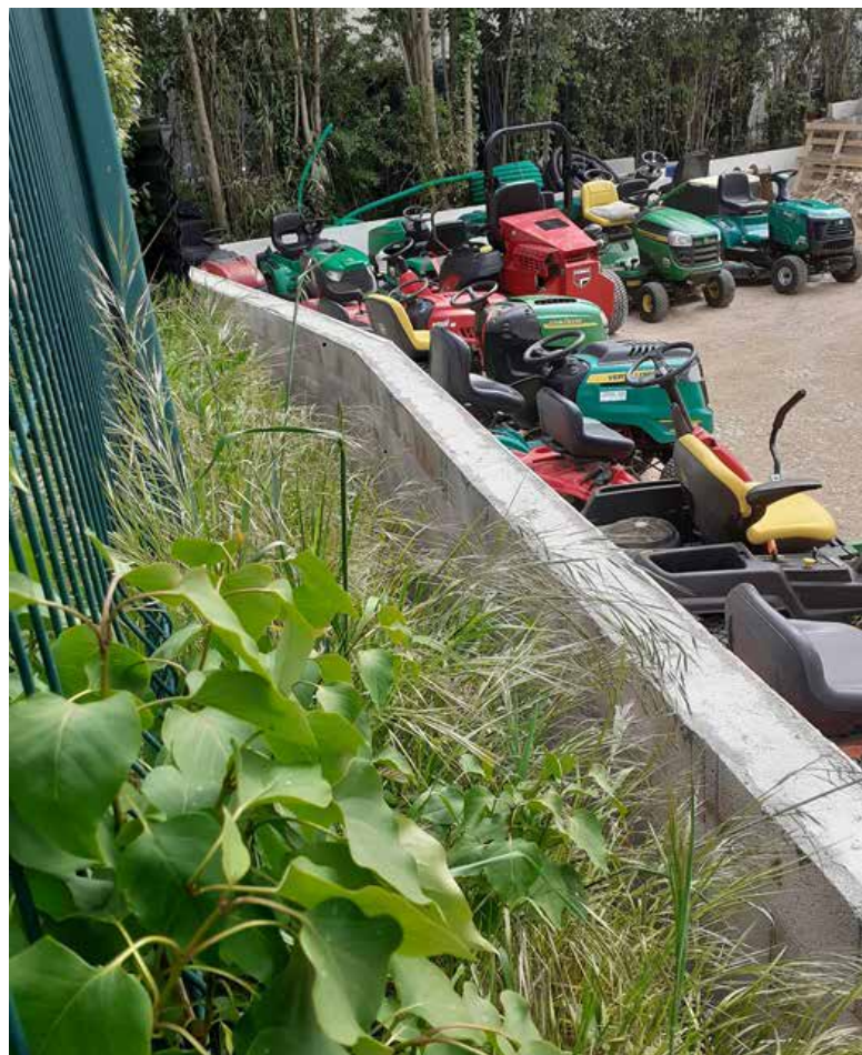
Empiètement non déclaré et réalisé sur la digue et les remblais de protection contre les inondations. photo DREAL Occitanie
