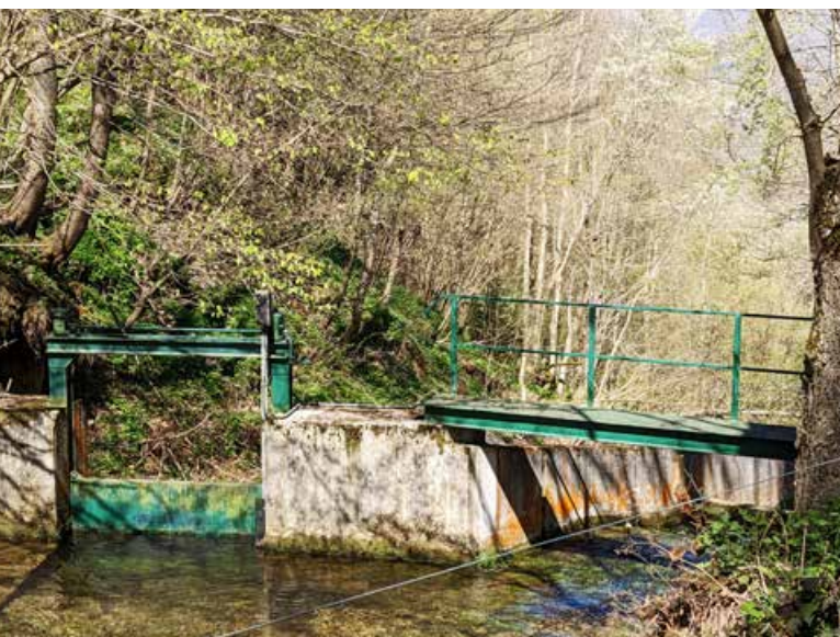
Aménagement hydroélectrique du Goulier - photo DREAL Occitanie
