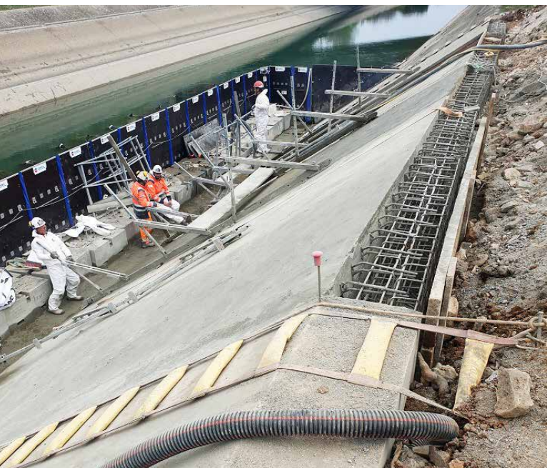
Batardeaux mobiles sur le Canal Philippe Lamour - photo DREAL Occitanie
