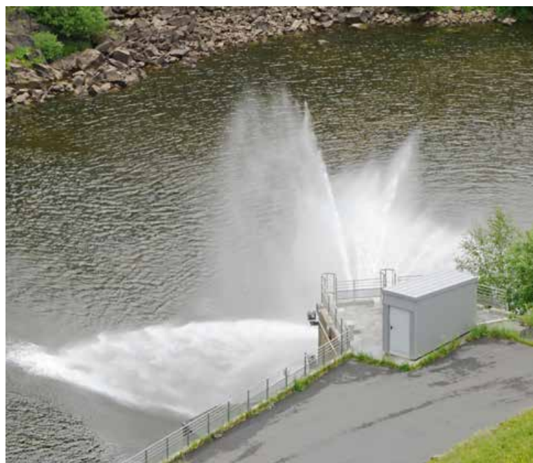
Vanne jet creux en action sur le barrage de Naussac – photo DREAL Occitanie
