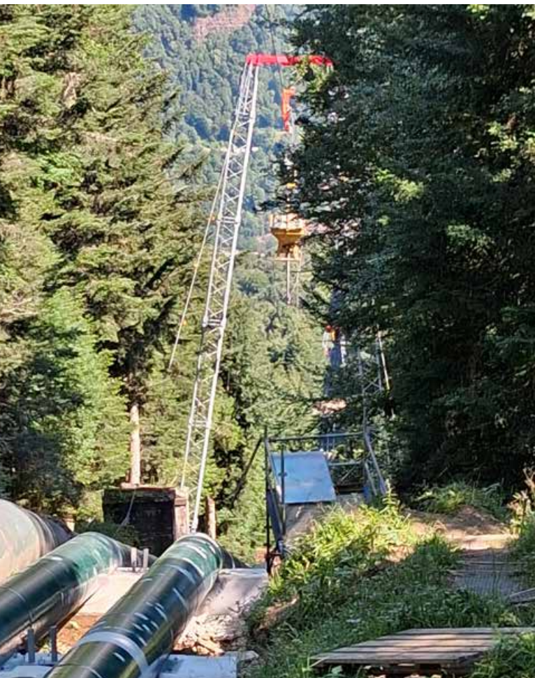
Conduites forcées du lac d'Oô - photo DREAL Occitanie
