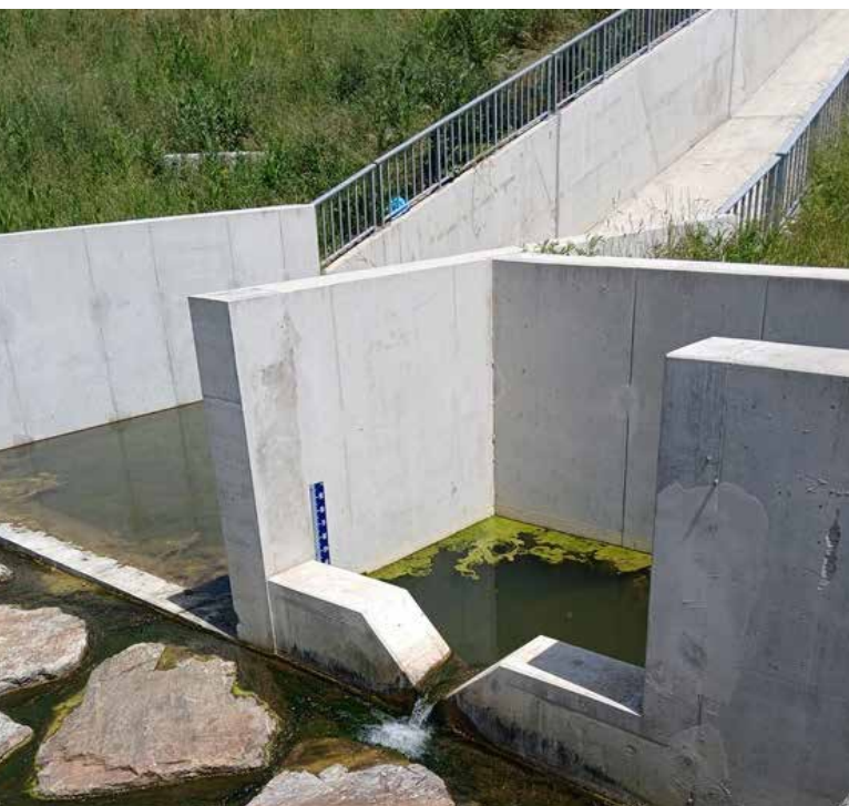
Bassin de dissipation et exutoire du débit restitué du barrage de Saint-Cricq - photo DREAL Occitanie
