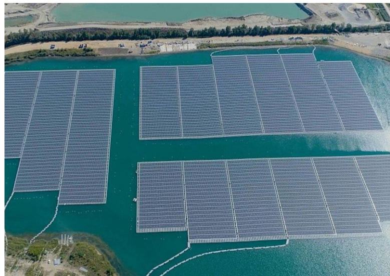
Figure 7 : centrale Photovoltaïque Flottante Technologie « ciel et Terre » 17 MWc (Piolenc, Vaucluse)
