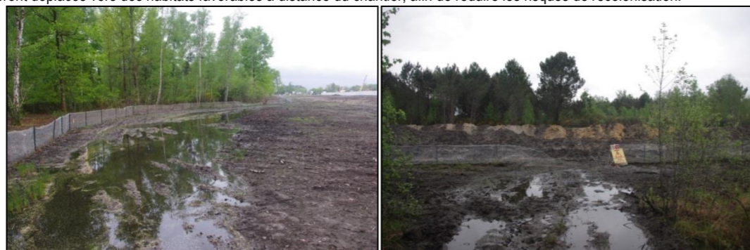
Ornières et flaques favorables aux amphibiens créés par des engins de chantier – Photographies : Naturalia
