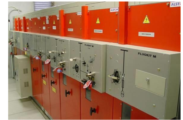
Cellules électriques du poste de livraison
