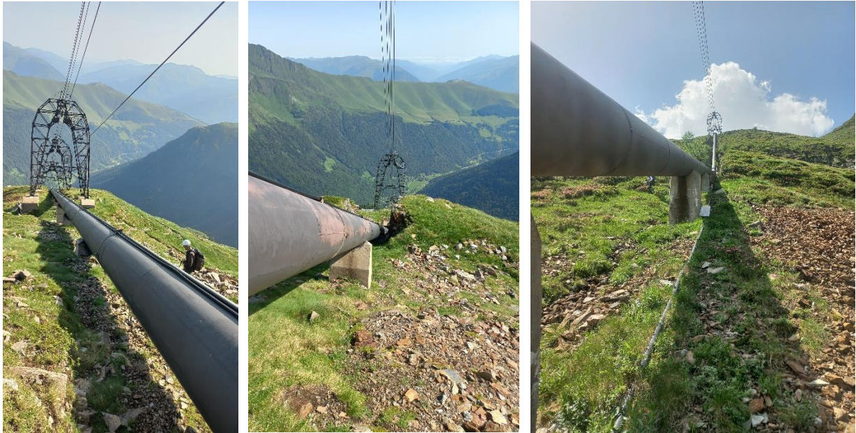
Figure 32 : Illustrations des milieux au droit de la conduite dans sa partie supérieure (zone de travaux N°3) (Source : ING'EUROP juin 2025)
