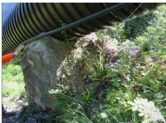
Figure 25 : Exemple d'une sellette à réfectionner
