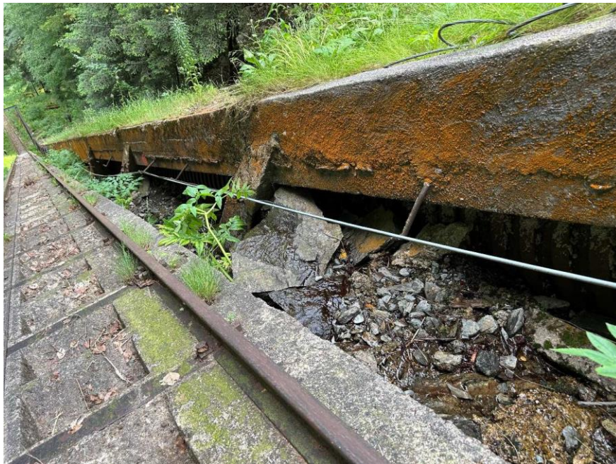
Figure 18 : Exemple d'une zone à déblayer à l'aval de la galerie, sous le platelage de protection de la CF (source GETEC)
