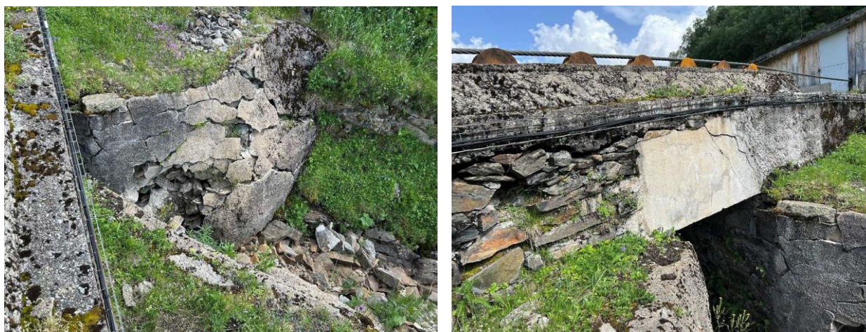
Figure 26 : Ouvrages de soutènement à reprendre (à gauche) et poutre en béton armée à conforter (à droite)
