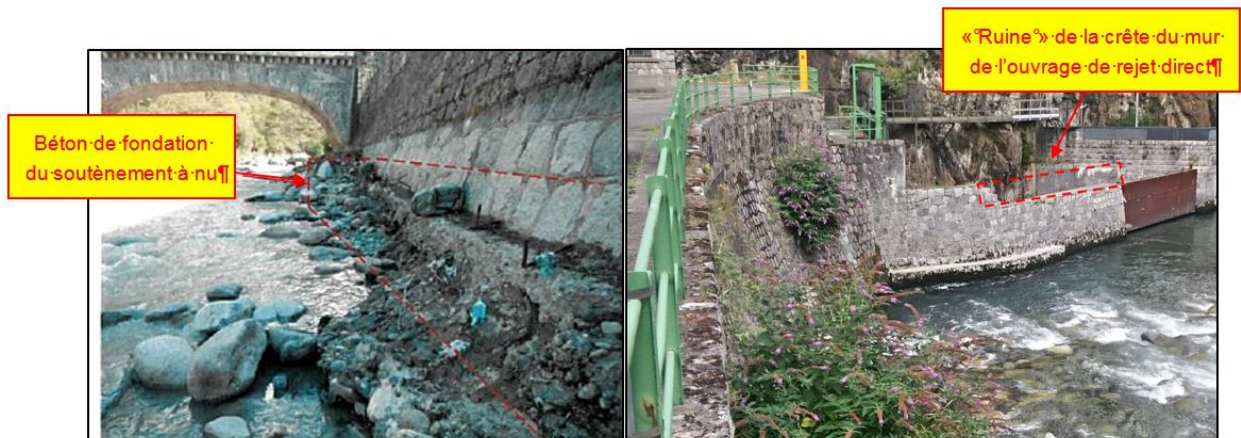
Figure 9 : dégradations constatées sur les murs de l'usine de Pont de la Reine
