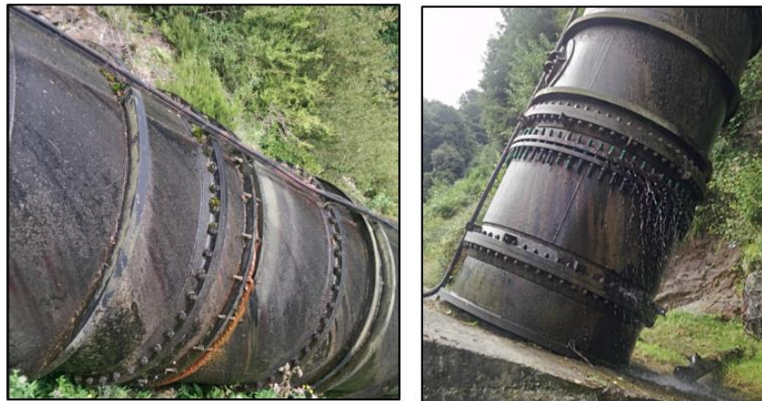
Figure 11 : Zone de la CF où l'étanchéité des joints doit être reprise
