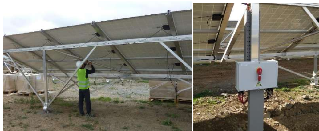
Figure 22 : A gauche : Câblage des panneaux – A droite : Boîtier de raccordement - RES
