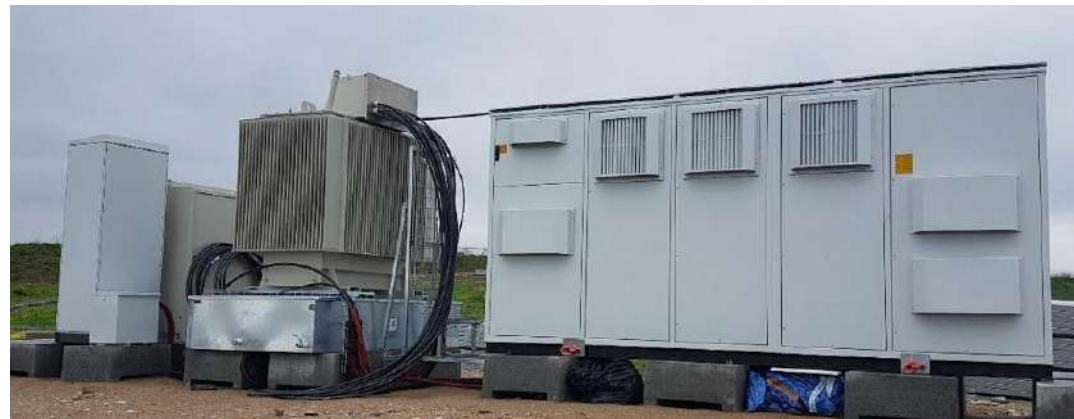
Figure 11 : Exemple d'onduleurs et transformateur installés à l'extérieur
