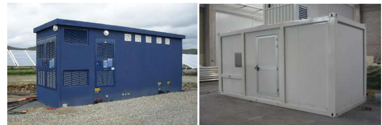
Figure 9 : Exemples d'onduleurs et transformateur installés dans des postes béton et containers
