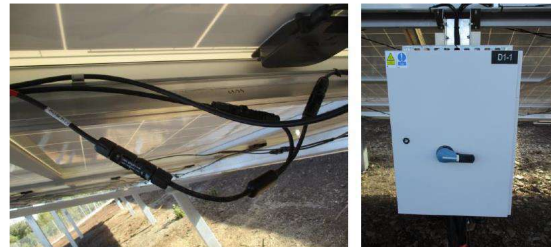
Figure 13 : Exemple de câble électrique et de boîte de raccordement – RES
