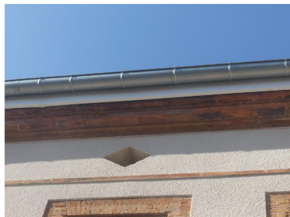
Installation de nid non favorable : corniche gênant la construction
