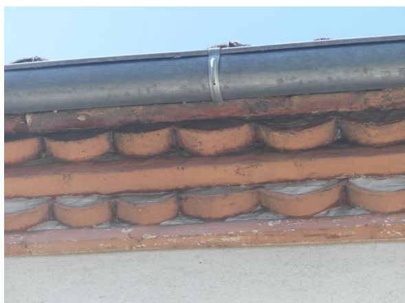
Installation de nid non favorable : génoise gênant la construction
