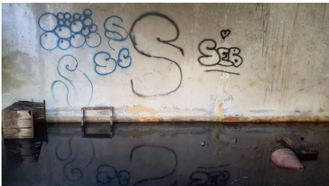
■ Photographie 13 : Bâtiment Nord de l'ancienne STEP concerné par la démolition, inondé
