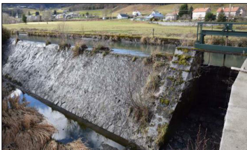
Figure 8 : La vanne de chasse du canal d'amenée
