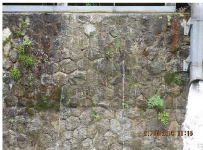
Figure 55 : Vue des fuites dans la partie supérieure de la maçonnerie du bassin de décantation
