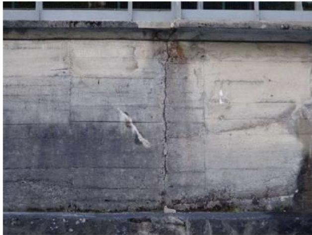
Figure 56 : Fissure du bajoyer externe rive gauche du bassin (gauche)
