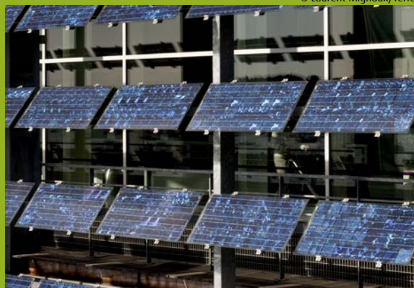
Panneaux photovoltaïques utilisés en pare-soleil.
