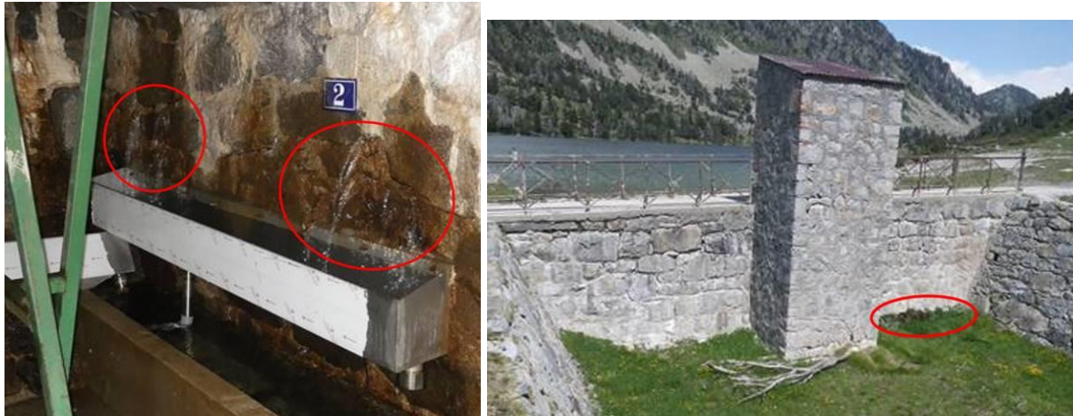
Figure 35 : Vues des fuites et bac de collecte sur les murs latéraux du local vannes de fond (à gauche) et des fuites au-dessus du local vannes de fond (à droite)
