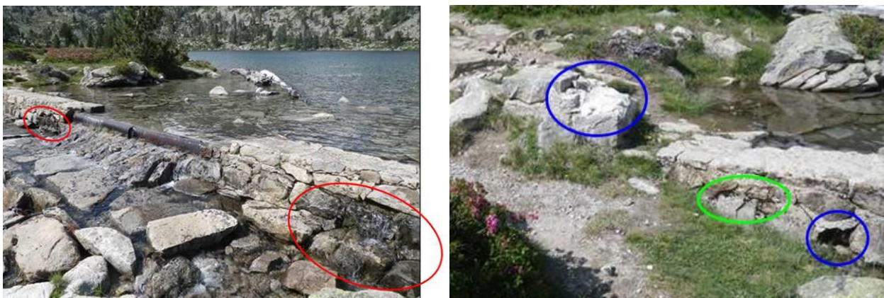
Figure 42 : Exemples de joints dégradés, percolations et pierres descellées
