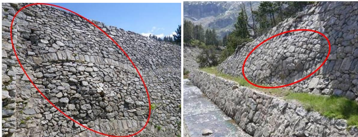
Figure 39 : Exemples de déformation des maçonneries dans le chenal aval
