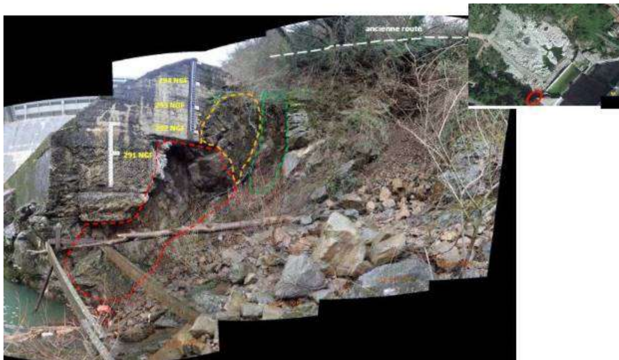
Figure 17 : Vue de la zone concernée (berge aval RG) par les travaux (en rouge = zone sous cavée, avec éboulis ; en vert = faille subverticale rive à rive).
