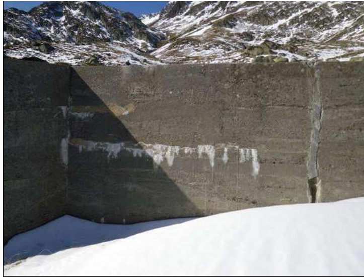
Figure 62 : Dégradation de l'extérieur du bassin
