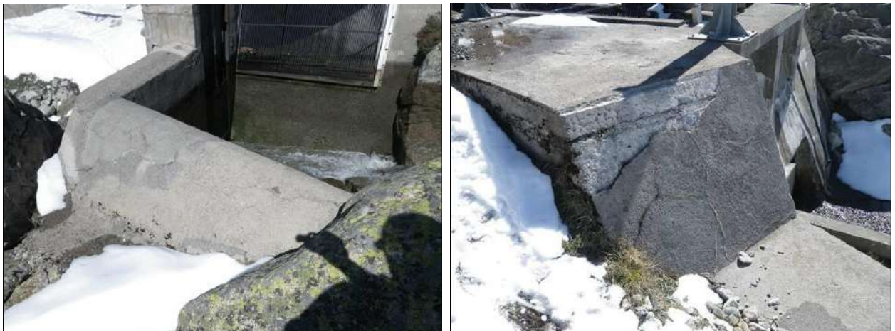
Figure 75 : Dégradation du déversoir et de l'extérieur du bassin
