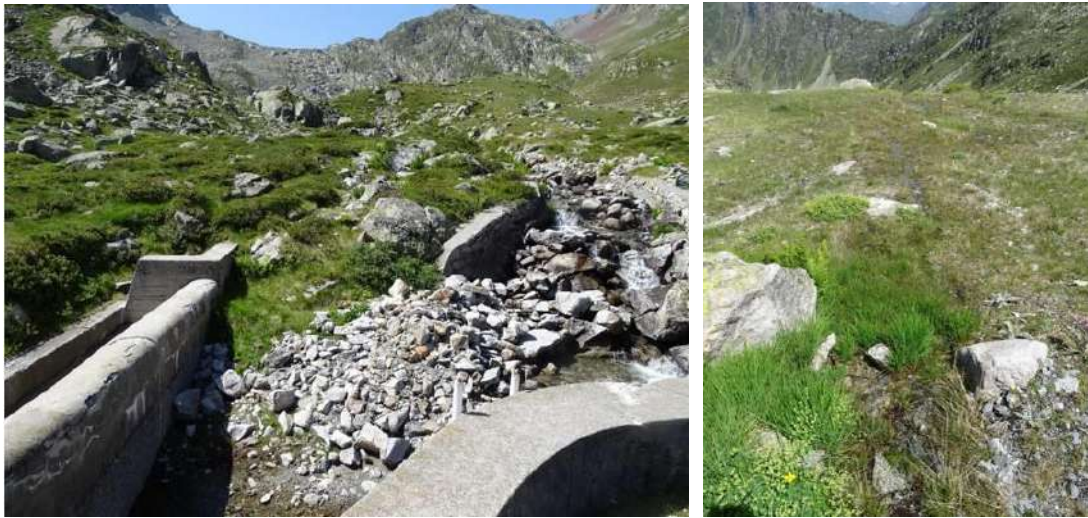
Figure 56 : Illustration de la micro ZH en amont de la prise d'eau et de la ZH plus conséquente sur la plateforme en aval
