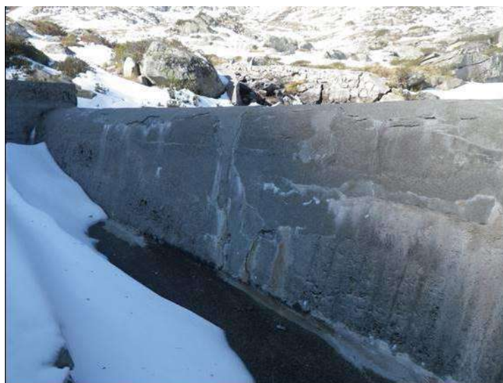
Figure 61 : Dégradation du déversoir
