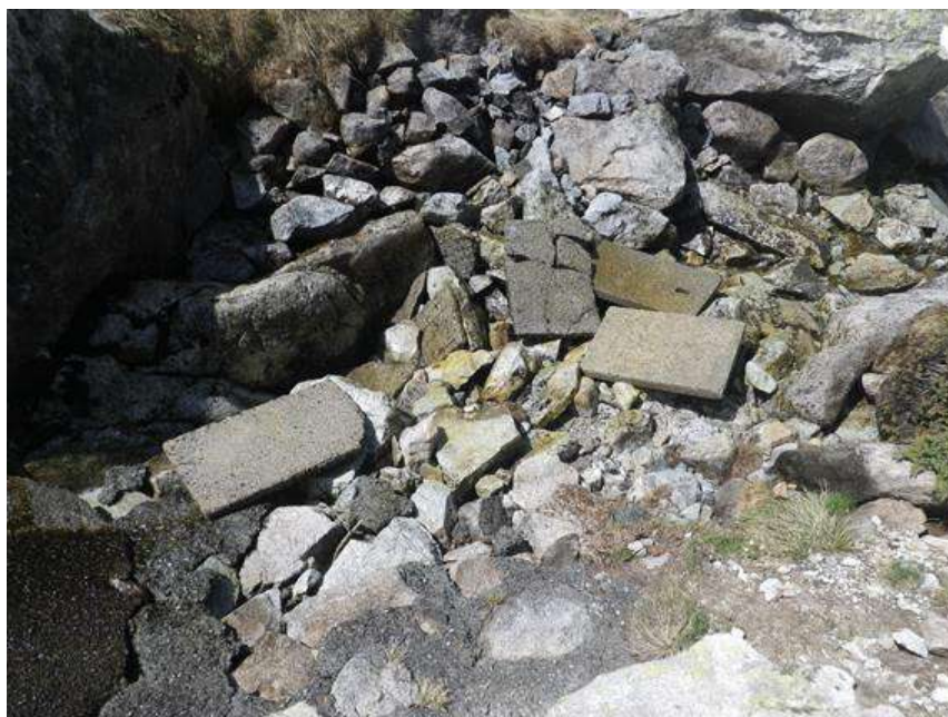
Figure 50 : Canal d'aménée – Dalles détériorées à évacuer
