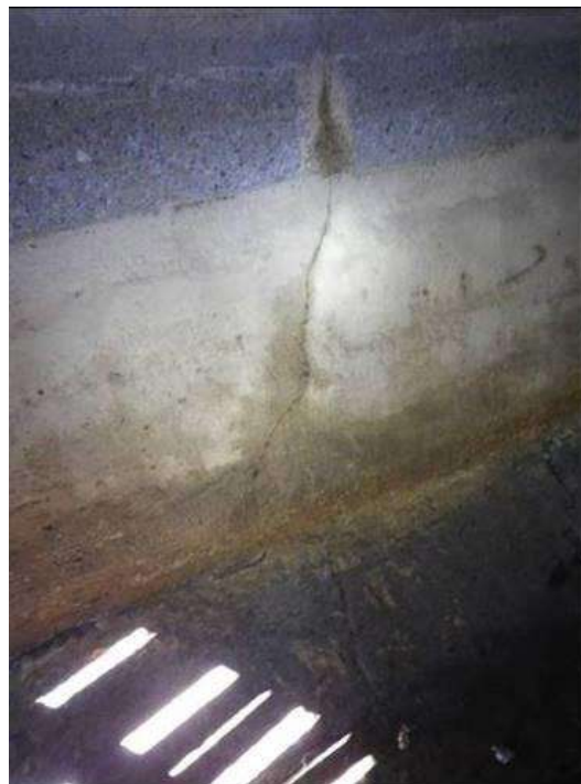
Figure 63 : Fissure dans le bassin à traiter
