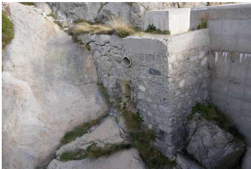
Figure 101 : Départ du chemin de randonnée : Maçonnerie à réparer
