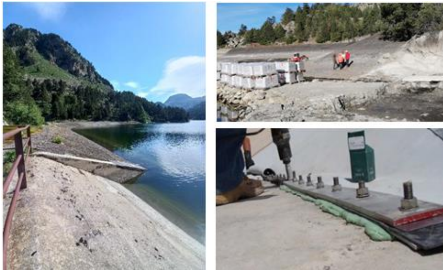
Figure 6 : Fermeture en rive gauche de la digue (photo de gauche) Fermeture en rive droite de la digue sur le rocher / Exemple d'une fermeture étanche périphérique sur une structure en béton armé (photos de droite)
