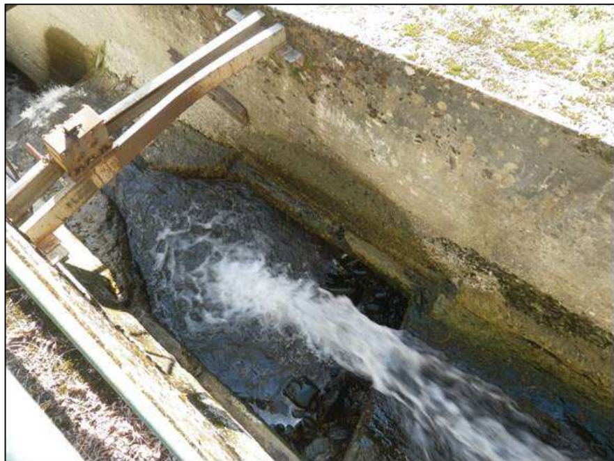
Figure 11 : Dégradation des organes mécaniques et engrèvement complet du bassin
