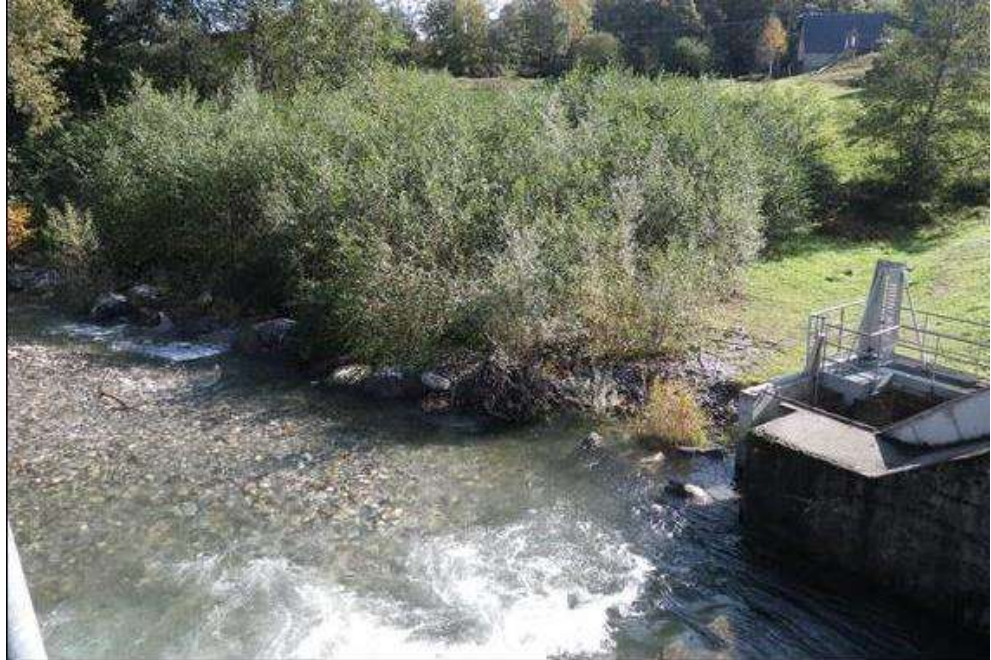
Figure 6 : Erosion de la berge aval rive droite et affouillement du pied aval du débit réservé
