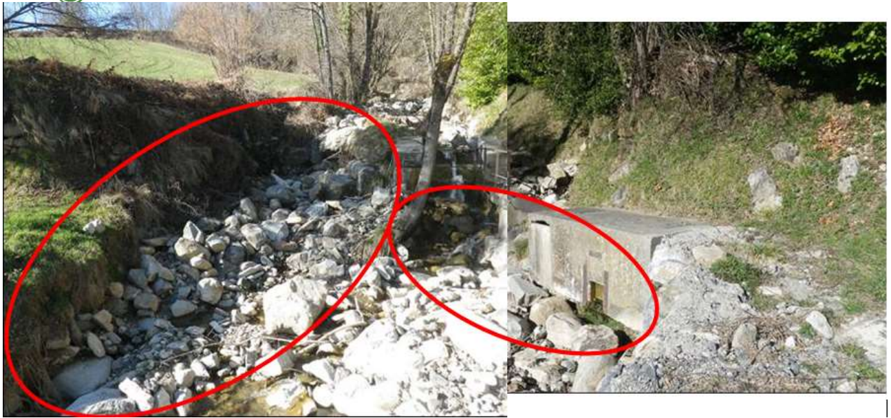
Figure 17 : Vue aval de la PE : érosion de la berge RD (à gauche) et du pied aval des ouvrages (à droite)
