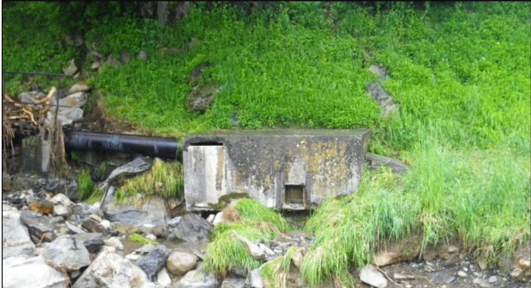
Figure 15 : Affouillement du bassin de captage
