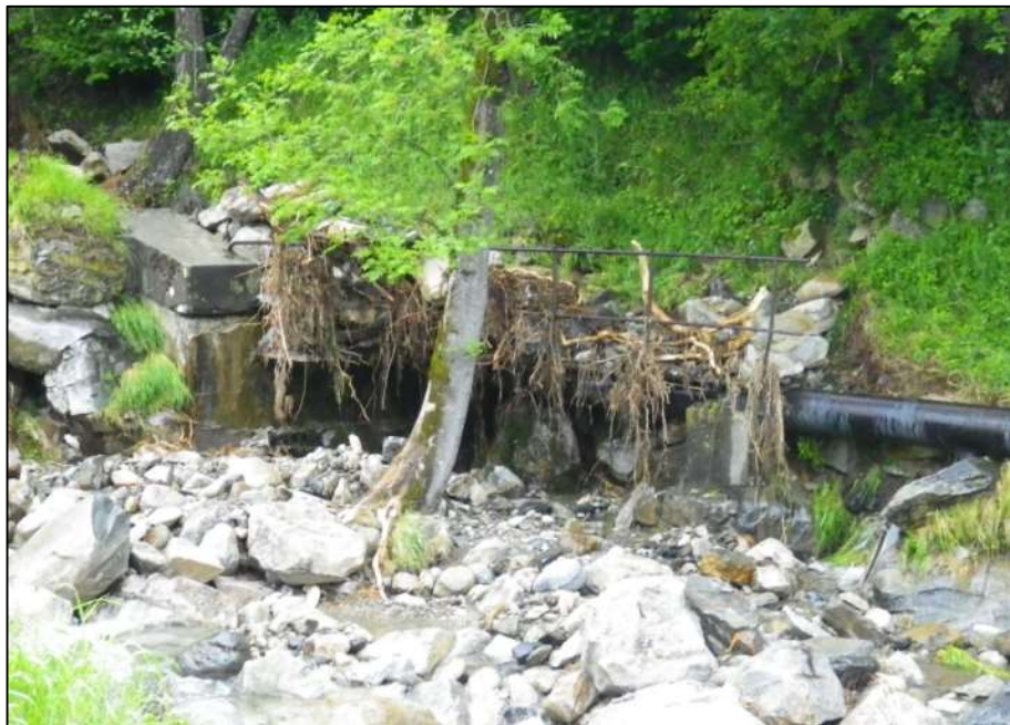
Figure 16 : Vue de la passerelle obstruée par les embâcles
