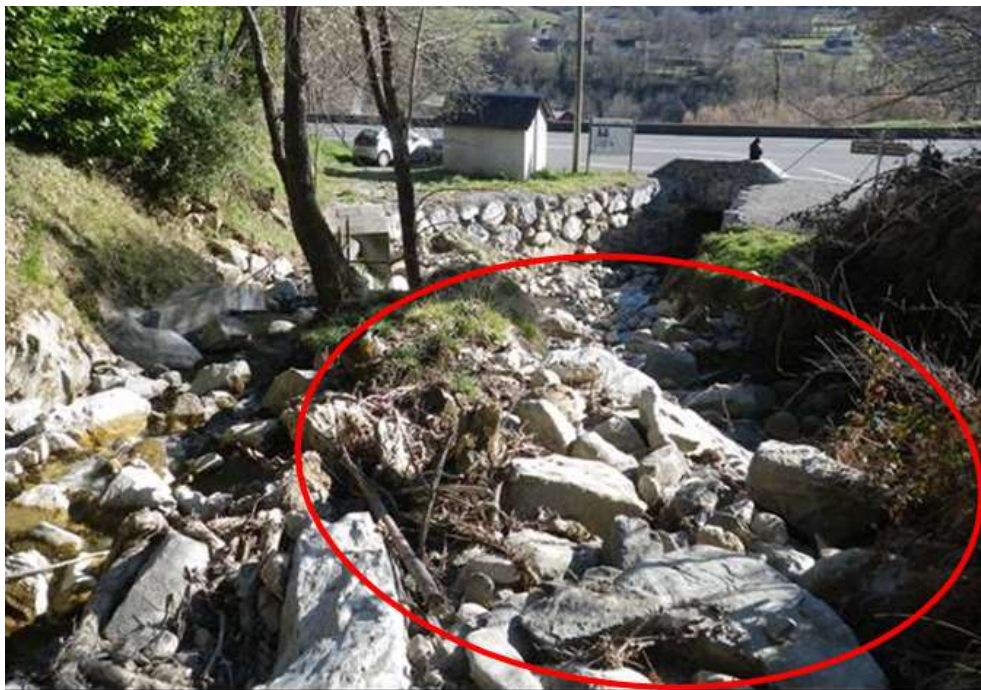
Figure 18 : Erosion de la berge RD vue de l'amont
