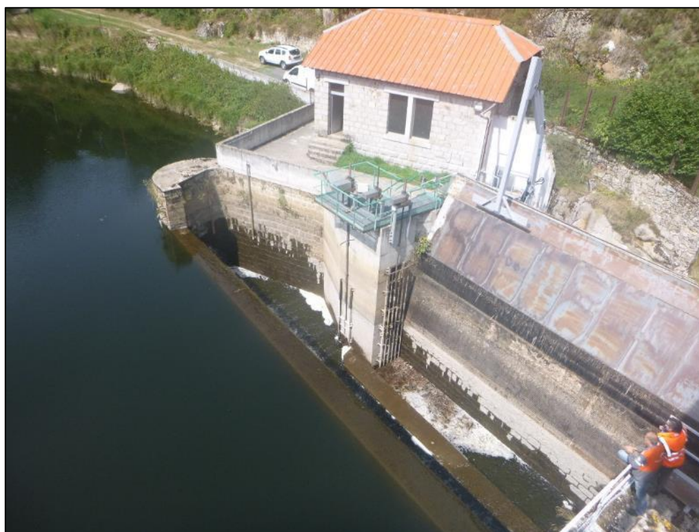
Figure 6 : Vue de la chambre d'accumulation en rive gauche du barrage
