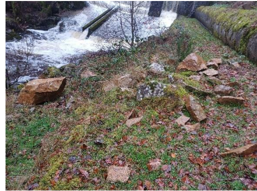
Figure 58: Eboulement en aval du barrage de la Bédaule
