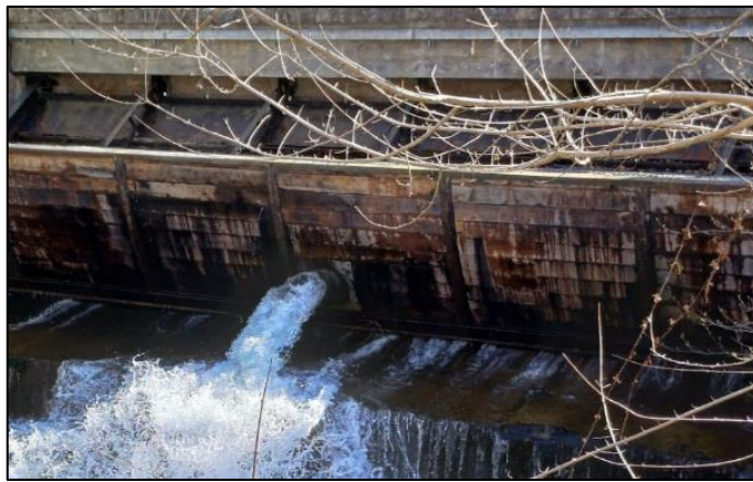
Figure 4 : Vue du rejet du débit délivré à l'aval
