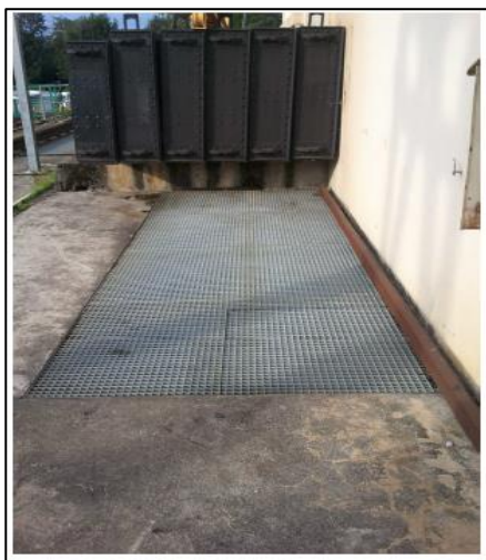
Figure 14 : Caillebotis d'accès aux dessus des chambres
