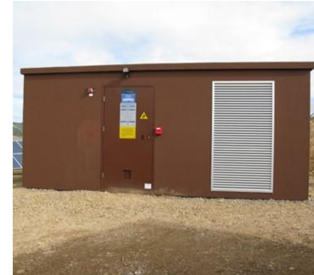
Figure 14 : Photographie d'un poste transformateur
