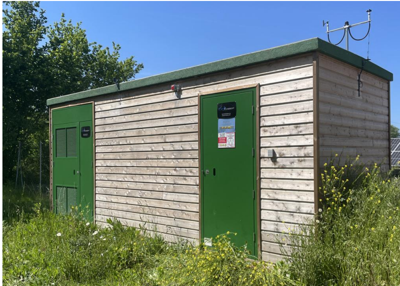
Figure 16 : Photographie d'un poste de livraison
