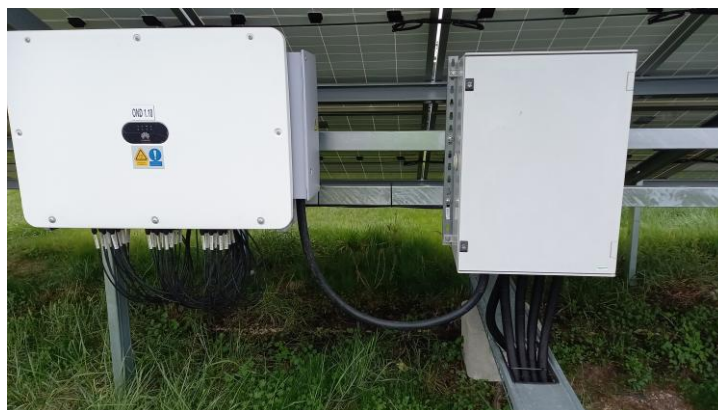
Figure 13 : Photographie d'un onduleur
