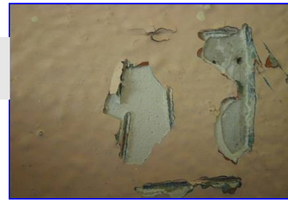
Enduits plâtre anti-bullage amianté
