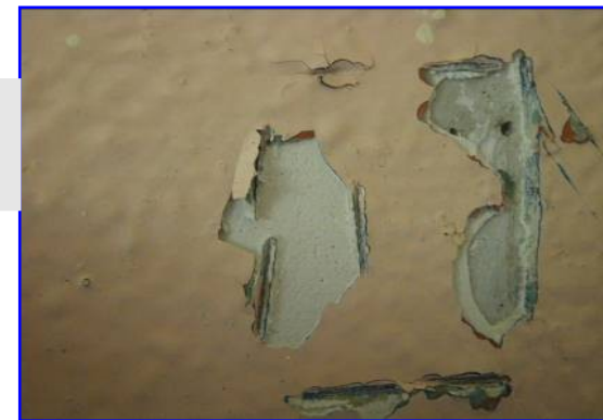
Enduits plâtre anti-bullage amianté
