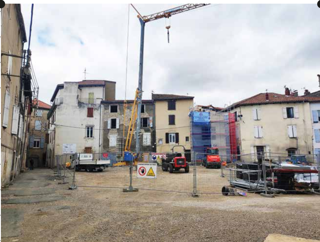
Travaux de création des 14 logements locatifs sociaux Crédit photo: commune de Millau
