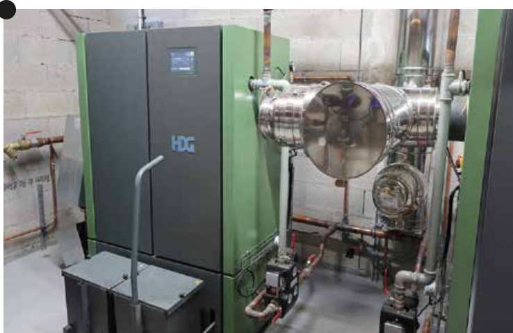
Chaudière biomasse alimentant le réseau de chaleur
