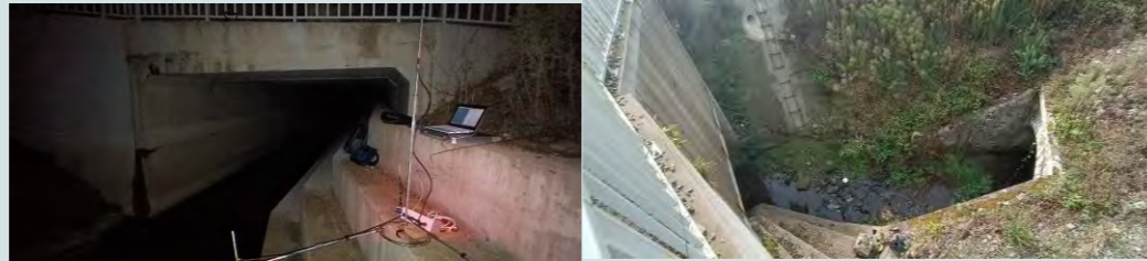
Photos 2 - Dispositif de trajectographie 3D sur ouvrage hydraulique jumelé pour définir les trajectoires de Grand Rhinolophe (© Egis - 2022)
