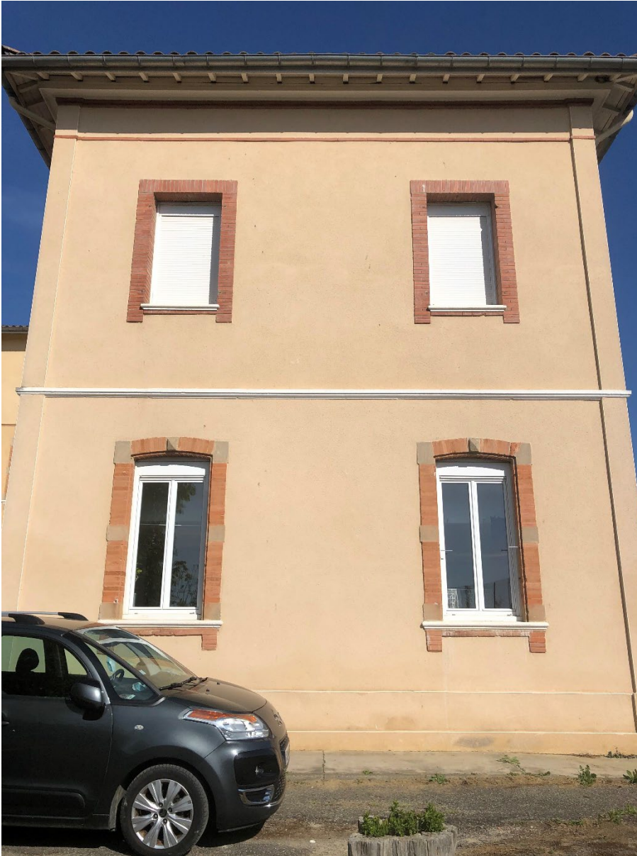
Façade SUD bâtiment 14, avec présence de nids.
