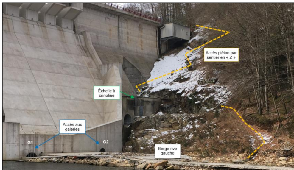
Figure 14 : Accès piéton à la berge rive gauche depuis le couronnement du barrage
