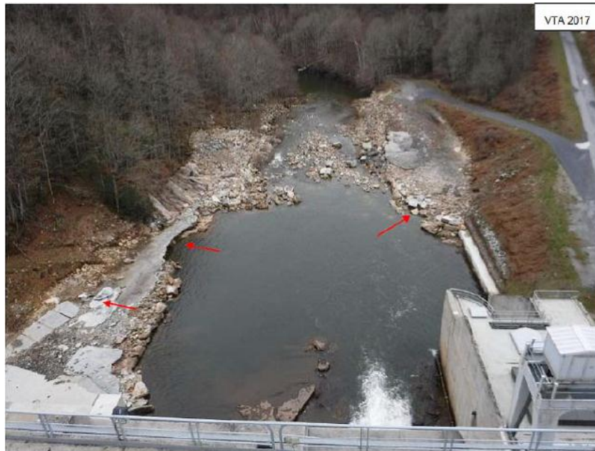
Figure 7 : Berges dégradées après la crue (vue depuis le couronnement du barrage)
