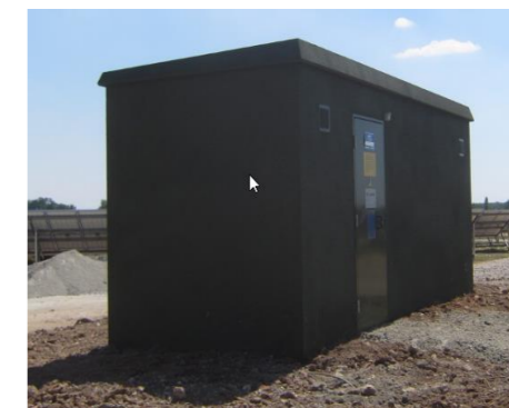
Figure 13. Exemple de poste de conversion « indoor » (source : NEOEN)
