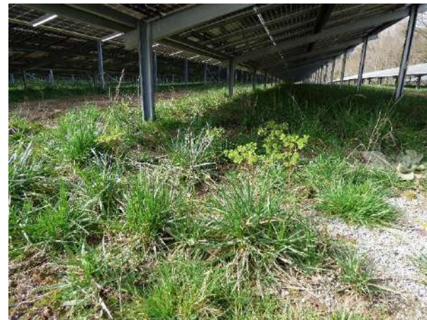
Reprise végétale sous les panneaux Cyril BOUSSIÈRE (Ecstudiz), 2021
