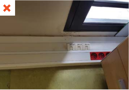
Présence d'eau stagnante dans les goulottes accueillant des réseaux électriques à la suite d'infiltrations d'eau par les jalousies, pourtant en position fermée. © AQC
