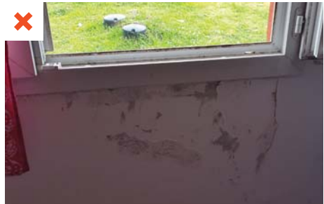
Infiltration d'eau par la traverse basse de la menuiserie extérieure et décollement de la peinture en allège. © AQC
