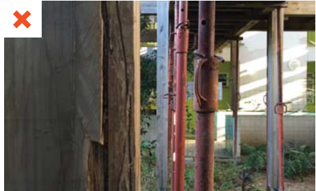
L'ossature bois de la coursive desservant l'entrée de plusieurs logements a subi une attaque de termites. Des étais ont été mis en place pour permettre son usage.
