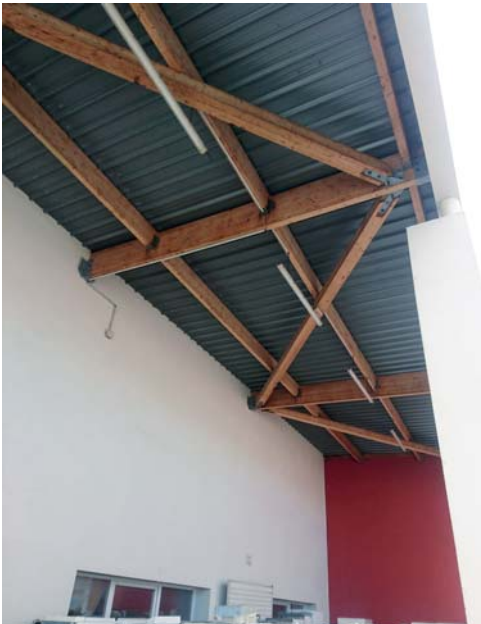
Poutre de lamellé-collé réemployée ayant subi des essais de résistance mécanique avant sa 2 ème vie en œuvre. © AQC
