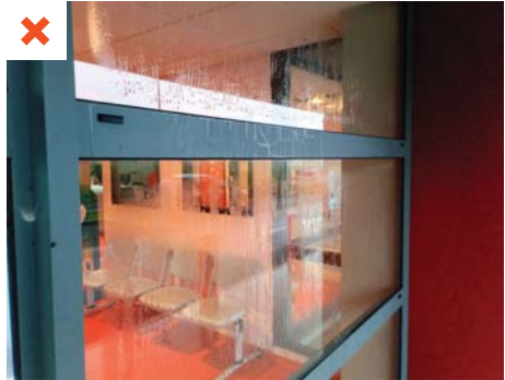
Condensation régulière sur la face extérieure des menuiseries simple vitrage de l'espace d'attente climatisé. © AQC
