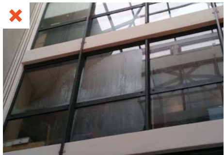
Seules les vitres des bureaux climatisés présentent une condensation sur la partie extérieure du vitrage. Les châssis, plus performants thermiquement que les vitrages, ne sont pas impactés. © AQC
