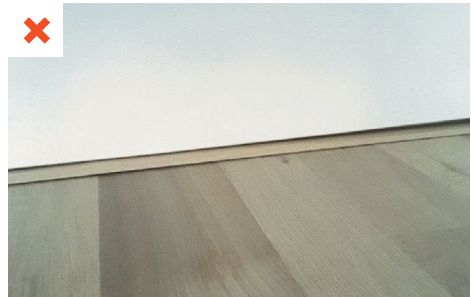
La sur-élévation du niveau du sol fini suite à la pose du parquet et de la barre de seuil entraîne la disparition du passage de transit initialement présent. ©AQC
