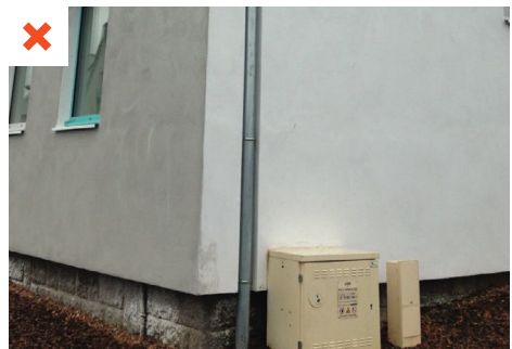
La descente d'eau pluviale n'a pas été déposée avant les travaux d'isolation, ce qui génère un important pont thermique linéaire. ©AQC
