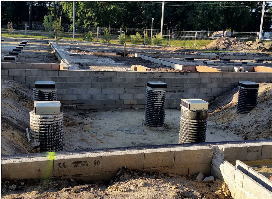
La conception des fondations de ce chantier a dû être revue après la passation du marché de travaux pour répondre aux prescriptions du système modulaire.
