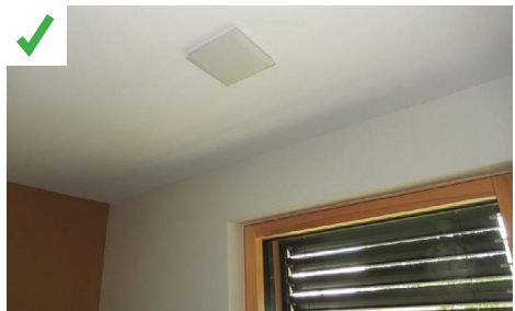
Présence d'une bouche à effet coanda dans une chambre. Le flux d'air est dirigé le long du plafond et aucune gêne n'est ressentie par les usagers. ©AQC
