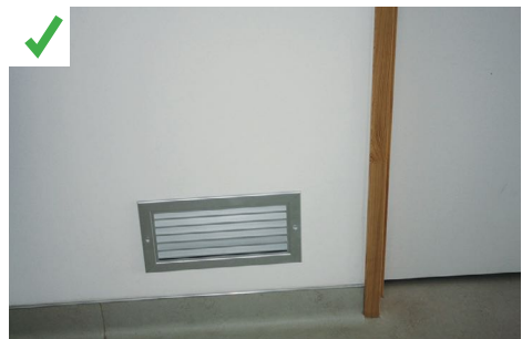
La grille de transfert présente dans la cloison permet de respecter le principe de balayage de l'air tout en assurant une atténuation acoustique... ©AQC
