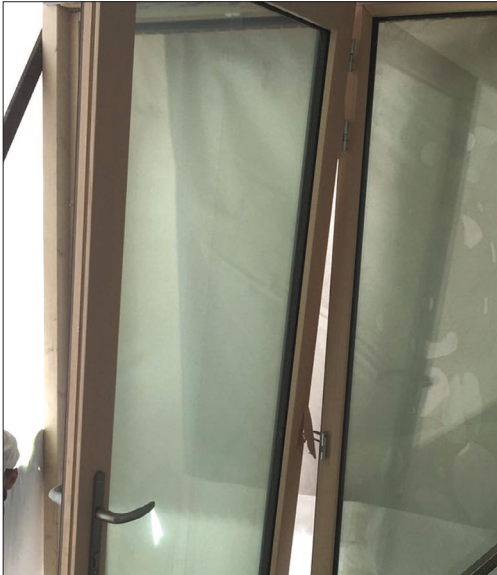
Arrachement du châssis suite à l'ouverture intempestive du vantail lors du transport.
