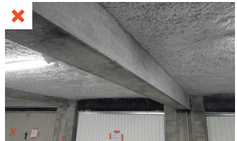
Les poutres en béton de ce garage n'ont pas été isolées (procédé de projection de laine minérale avec liants). ©AQC
