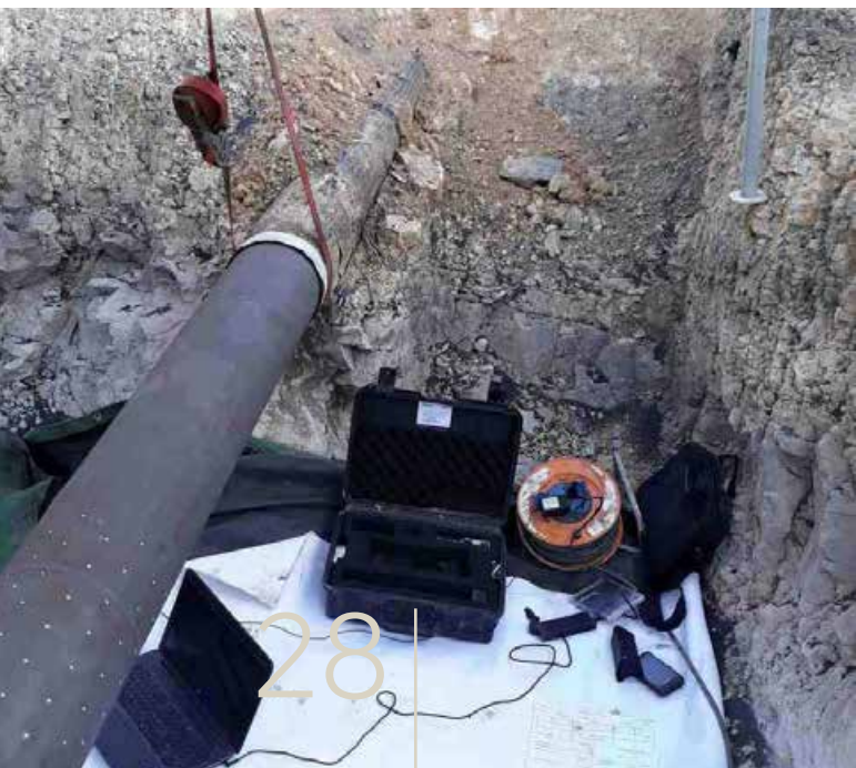
Canalisation de transport de gaz
