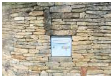
Intégration harmonieuse de la boîte aux lettres dans le mur de clôture
