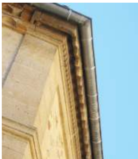
Corniche en pierre moulurée avec chevrons en saillie protégés par des lambrequins en bois
