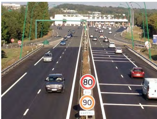
Illustration 106 : Le trafic en heure de pointe sur l'autoroute A68 à hauteur de l'Union
