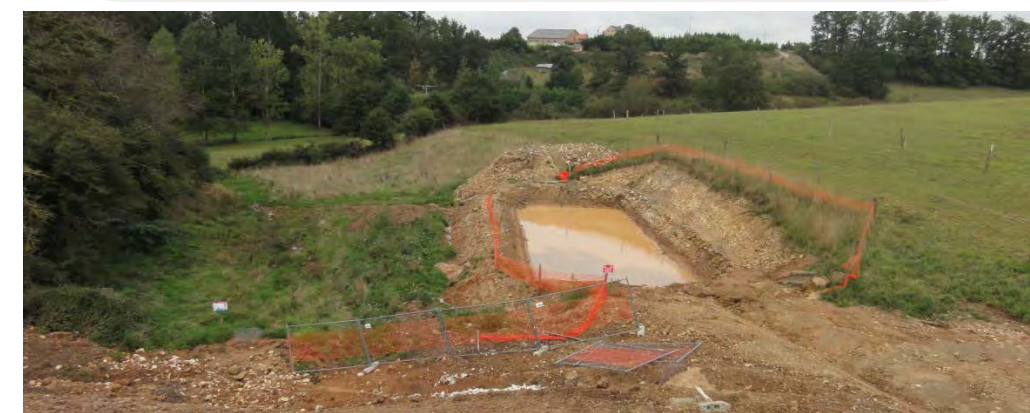
Bassin provisoire de traitement des eaux pluviales (source : EGIS)
