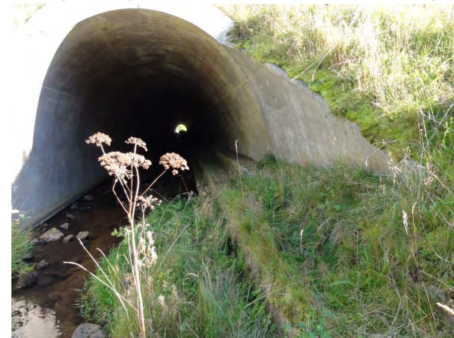
Ouvrage aménagé pour la faune semi-aquatique (Source : Egis)
