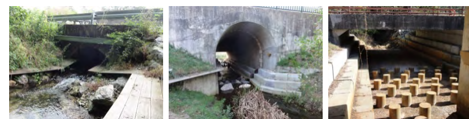
Aménagements de passages pour la petite et moyenne faune terrestre et semi-aquatique
