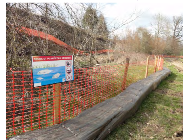
Mise en défens de milieux naturels sensibles (RN88, source : Egis, 2013)
