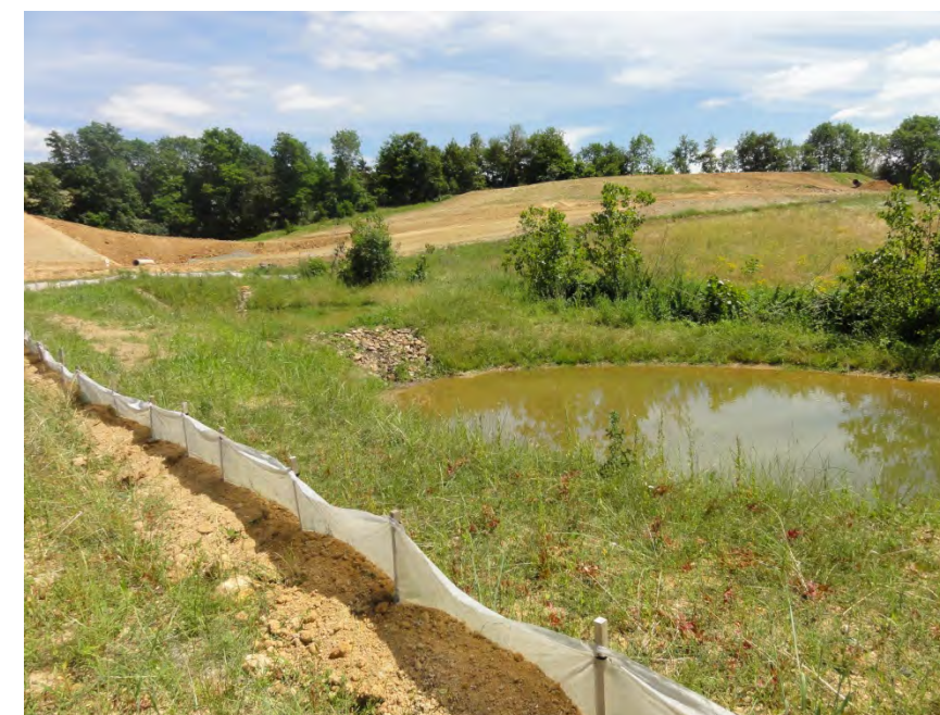
Mise en défens de milieu sensible en phase de chantier (RN88 ; source : EGIS, 2013)
